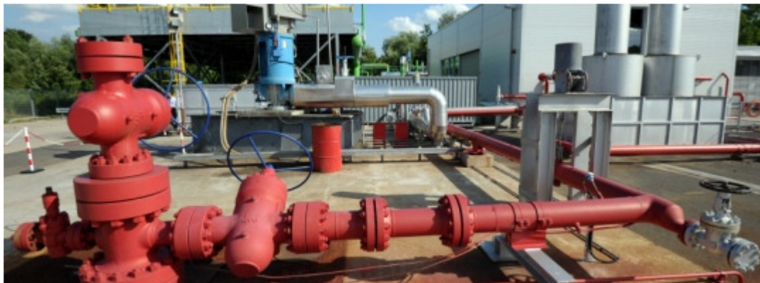
Das Geothermiekraftwerk in Landau (Foto) pumpt seit 2007 heißes Wasser aus dem Untergrund und nutzt die Wärme zur Stromerzeugung. (© dpa)
